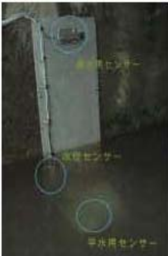
設置於小規模河川氾濫時之流速觀測
